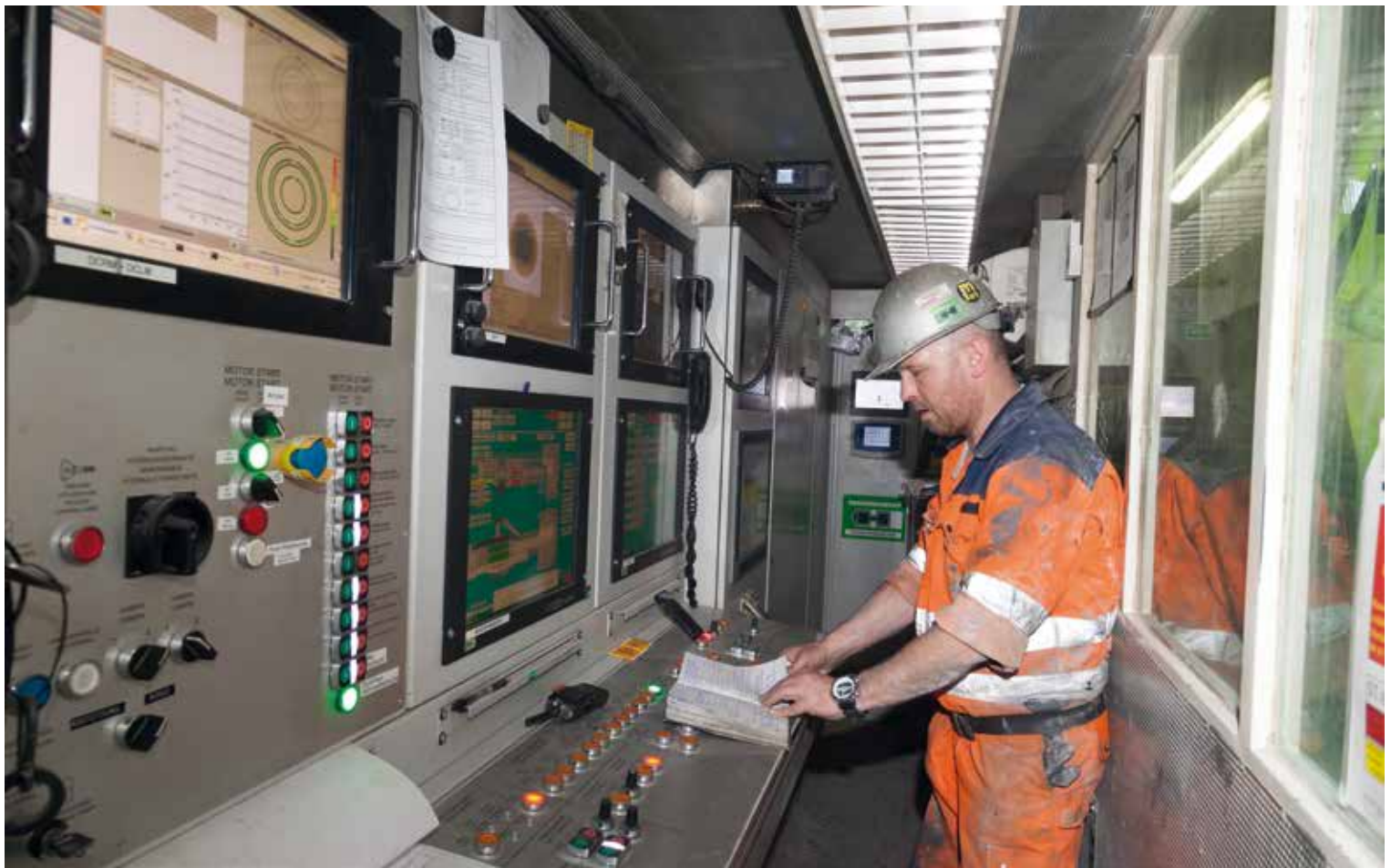
Im Steuerstand der TBM wird der maschinelle Vortrieb gelenkt und kontrolliert Nella postazione di controllo della TBM si guida e si controlla lo scavo meccanizzato
