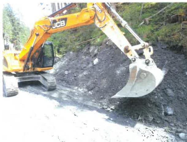
Abb. 2 Hangsituation vor Errichtung Maßnahmen (Stand 22.07.2019)
